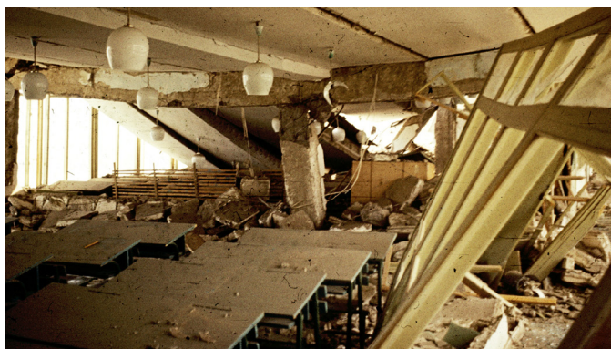
Разрушение школы при первом Газлийском землетрясении 1976 г. После второго толчка строение рухнуло полностью
