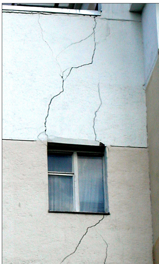
Рис. 3.1.6. Крупные трещины на уровне 6-го этажа со стороны ул.Ф.Энгельса.
