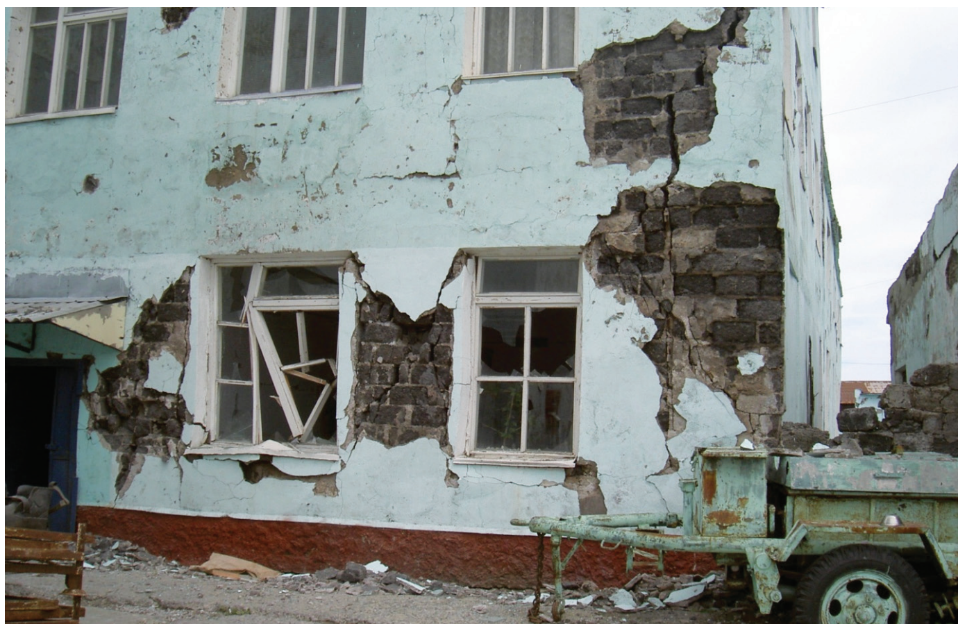
Рис. 3. Последствия Невельского землетрясения на юге о. Сахалина 02.08.2007 г. Разрушение здания школы (фото Г.Л. Коффа)
