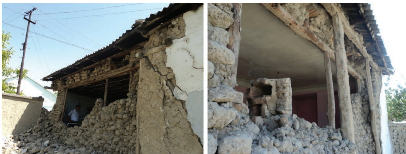
Рис. 1. Разрушение жилых домов из местных материалов при воздействии Канского землетрясения в Баткентской области (Кыргызстан), 20.07.2011 г., M=6,2 (Ш.А. Хакимов, 2011)
